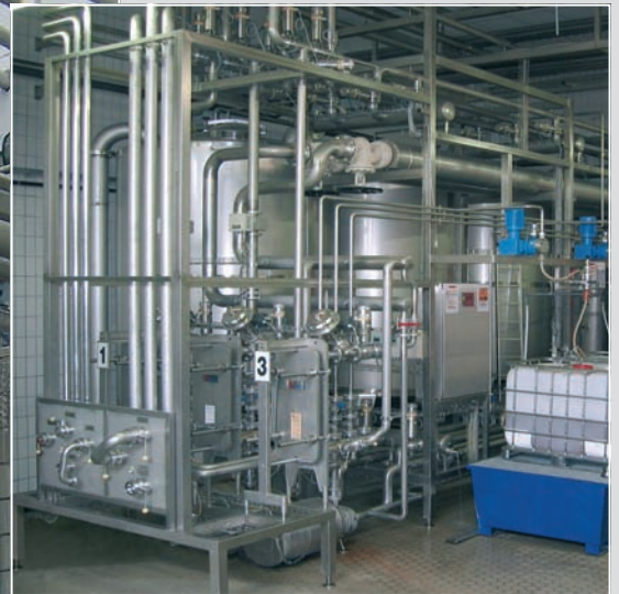
▶ CIP-Station Sirupraum mit Konzentratversorgung
