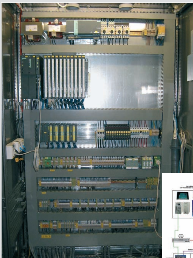
▶ Steuerschrank mit S7-400 und dezentraler Peripherie
